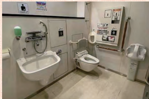
左側がオストメイト用設備。浜松サービスエリア(NEXCO中日本) 出典：共生社会におけるトイレの環境整備に関する調査研究 報告書(国土交通省総合政策局安心生活政策課)
